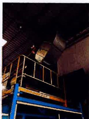
6#喷漆废气排放口 (FQ-39209-6)
