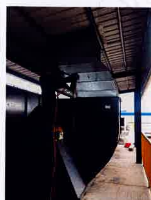
8#喷漆废气排放口 (FQ-39209-7)
