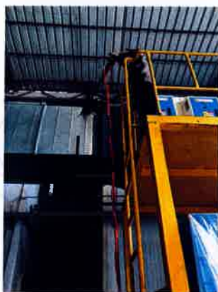
1#喷漆废气处理前采样口 (FQ-39209-4)
