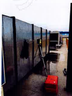
7#喷漆废气处理前采样口 (FQ-39209-7)
