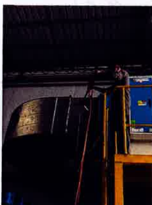
3#喷漆废气处理前采样口 (FQ-39209-5)
